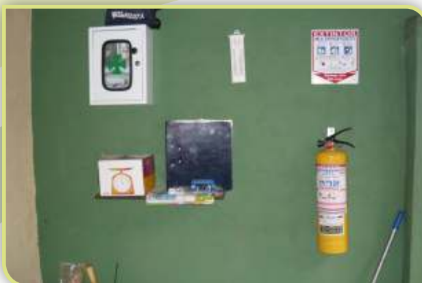
Figura 30. Botiquín, extintor señalizado. Fuente: Proyecto Santa Rosa, Boyacá.
